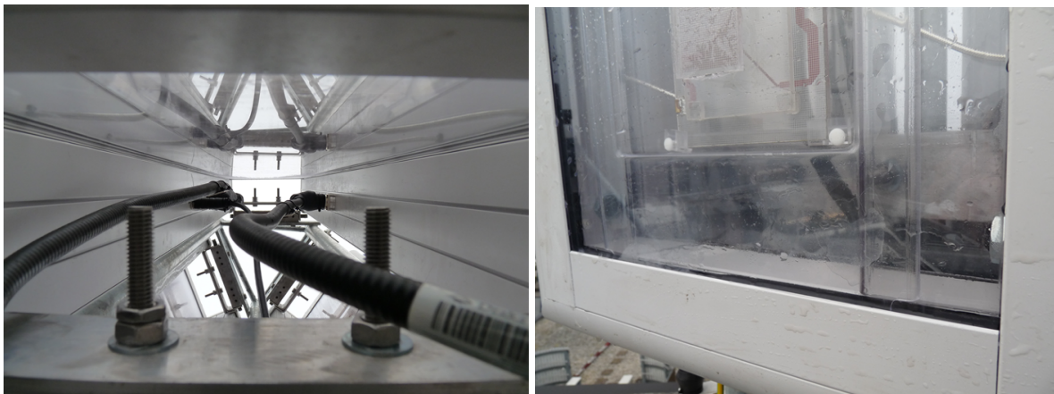
(a) Câbles RF
