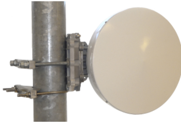
FIGURE 1.27 : Exemple d'antenne parabolique FH
