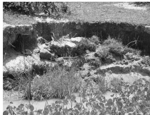
Photo 81 : Berge totalement écroulée au site de Douka
