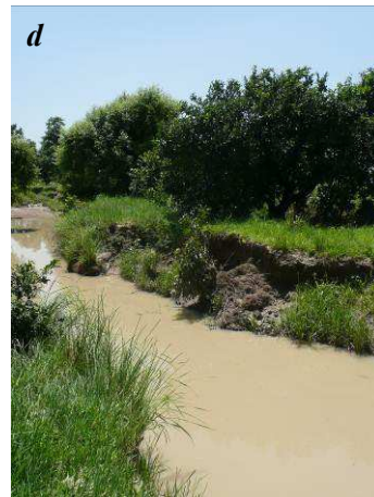
d : Berges érodées suite à un événement pluviométrique Soulignent la force de l'écoulement suite à ces pluies intenses
