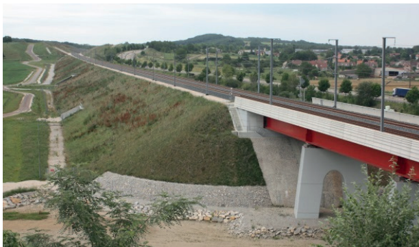
Figure 3. Emprise de LGV : passage en remblai dans un paysage de collines (47.3370 N, 6.0075 E).
