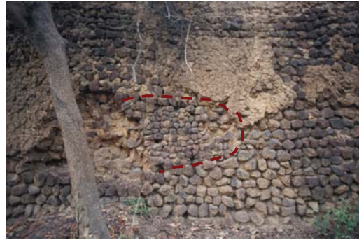
Zone réparée, sur la façade Sud du rempart, identifiable par une discontinuité de la maçonnerie et des moellons de taille réduite
