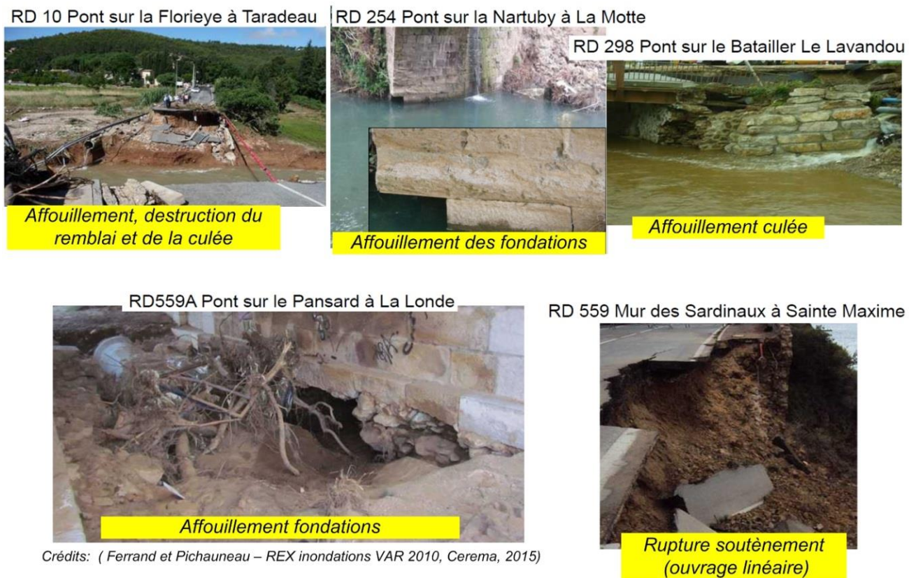
Figure 11 : Exemples de dommages aux ouvrages d'art par affouillement (Feraud and Picheneau 2015)
