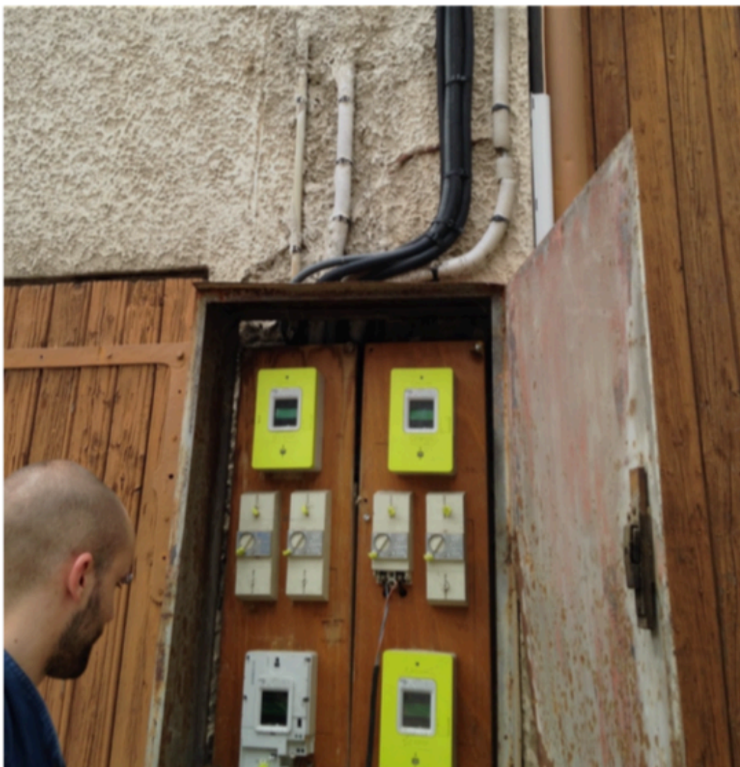
L'installation des appareils en extérieur des logements sans contact avec les clients. Quatre compteurs Linky raccordés dans la cour d'une copropriété, zone périurbaine, Caluire-et-Cuire, Grand Lyon, 21 mai 2014.
