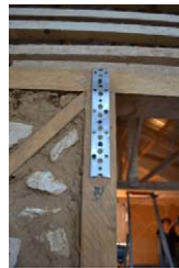
(d) HTI 300%: Filling–Location 7: South transv.wall
