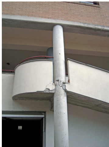
Exemple de colonnes courtes. Séisme de L'Aquila 2009
