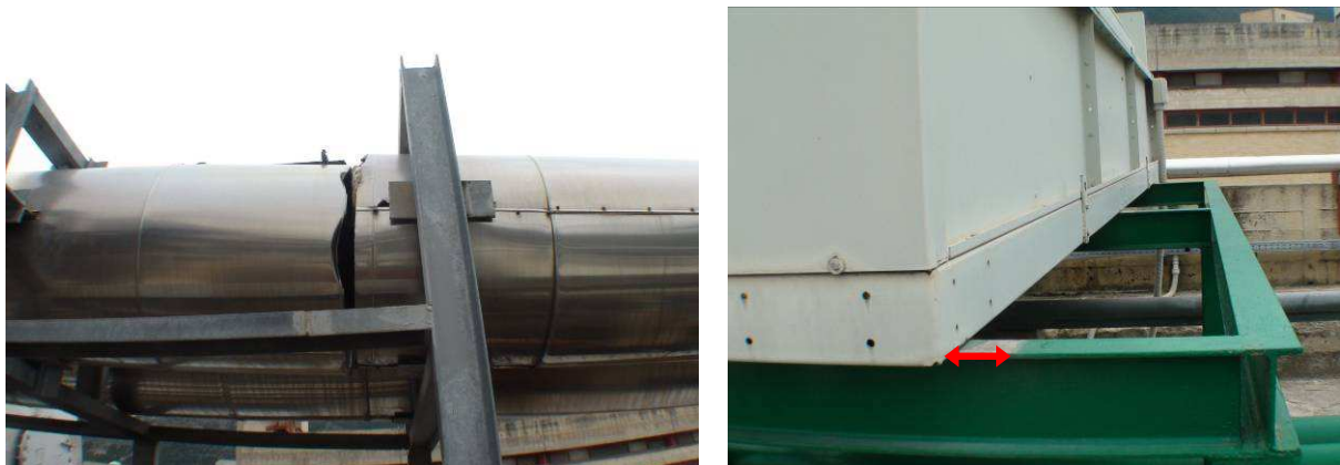
Domages aux installations, Hôpital de L'Aquila (2009)
