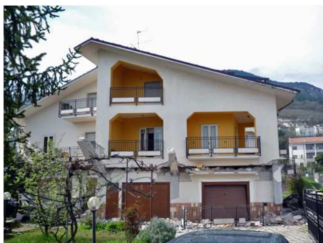
Etage souple. Séisme de L'Aquila (2009). Bâtiment situé à Pianola
