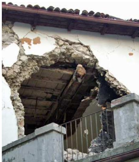
Exemple d'irrégularité locale. Collapse hors du plan de la maçonnerie due à l'action horizontale de la poutre en bois. Séisme de L'Aquila 2009
