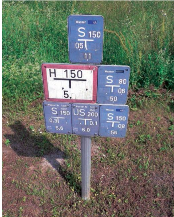
Le réseau d'eau à découvert : plaques indiquant les vannes et poteau d'incendie à Magdeburg (Allemagne). © D. FLORENTIN, 2013. ■
