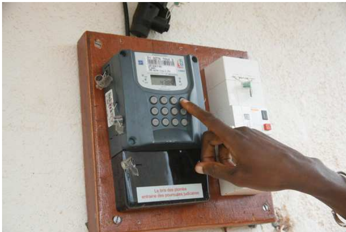
Compteur électrique prépayé, 2012
