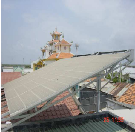
Figure 1 : Station solaire de France Telecom/ Orange sur l'île de Tahn Ahn (Vietnam).
