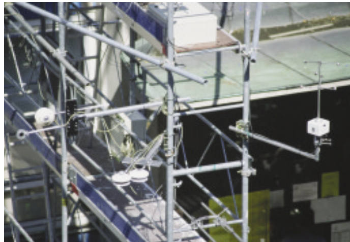
▲ Figure 2 : Appareils de mesures installés sur l'échafaudage de la rue de l'Argonne.
