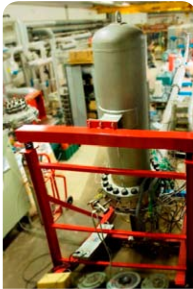
◀ Générateur thermoacoustique d'onde de l'IPN en cours de montage et installé au bâtiment 109. Banc d'amplification thermoacoustique d'onde au bâtiment 103.
