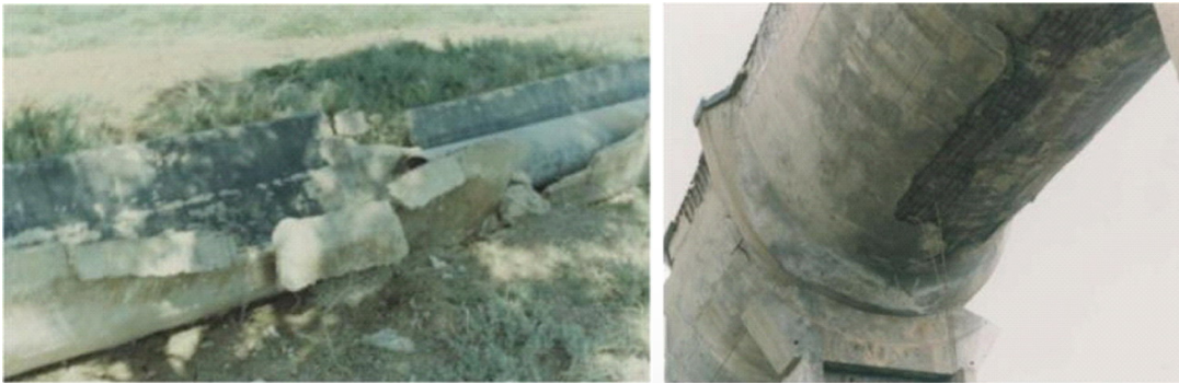
FIG. 4 – Type de détériorations observées dans les canaux porté
