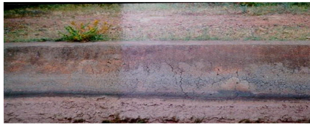
FIG. 1 – Faïencage de la couche supérieure du revêtement d'un canal rectangulaire, classes B ou C.
