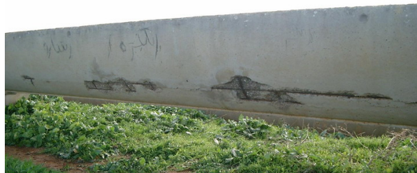
FIG. 5 – Décollement de la paroi extérieure d'un canal semi-circulaire à la suite d'une corrosion de l'acier très prononcée, classes D2 ou E.
