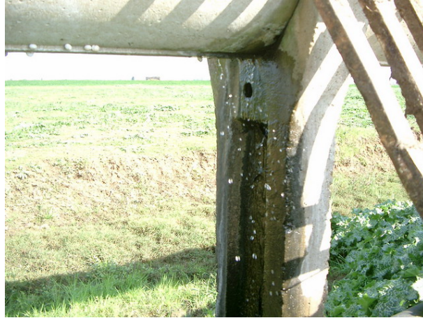
FIG. 7 – Joint détérioré avec fuites, classe E.
