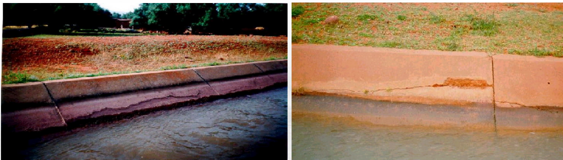
FIG. 3 – Fissures longitudinales sur canaux trapézoïdaux, classes D2 ou E.
