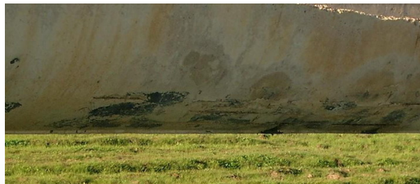
FIG. 8 – Salissure et tache d'humidité sur la paroi extérieure du canal, classe B.
