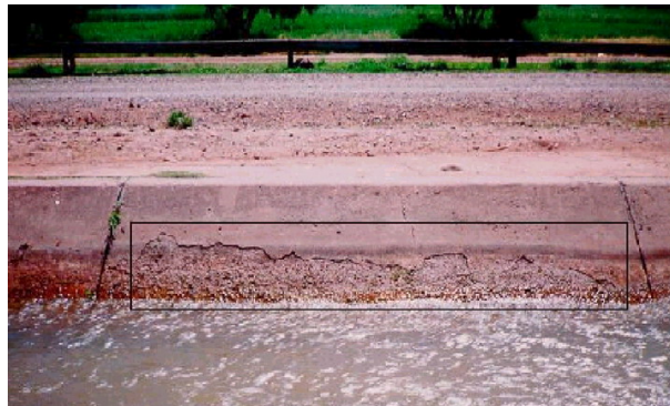
FIG. 2 – Ecaillage en zone de marnage, avec des petits cratères dans la partie supérieure du revêtement d'un canal trapézoïdal, classe D1.
