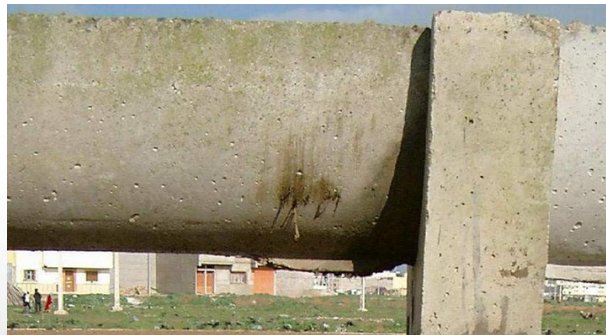
FIG. 6 – Mauvais état de surface, classe B.
