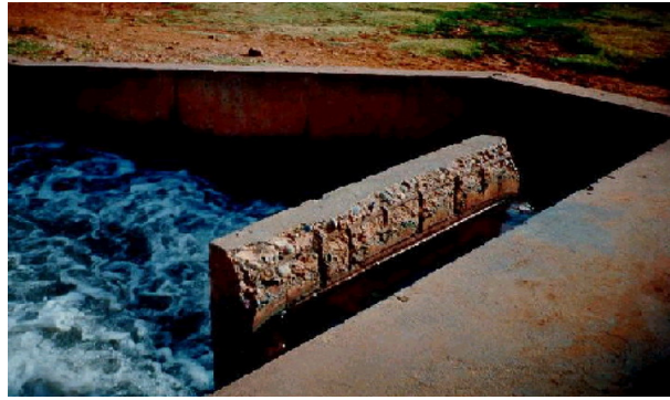
FIG. 4 – Eclatement du béton suite au développement de rouille expansive résultant de la corrosion des armatures d'un ouvrage de prise sur le canal, classe E.
